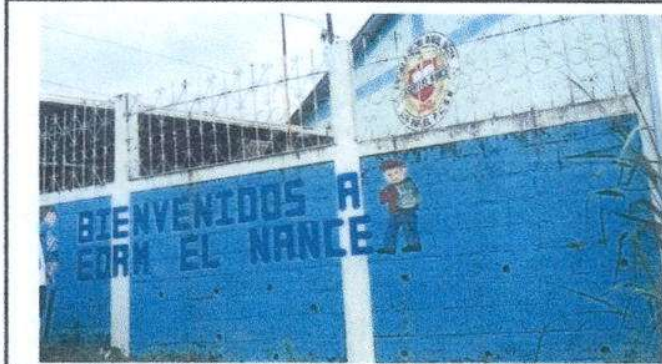
Foto 1: El establecimiento necesita pintura general
