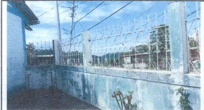
Foto 2: Se hace ver la necesidad de la pintura y reparación del piso de torta de concreto
